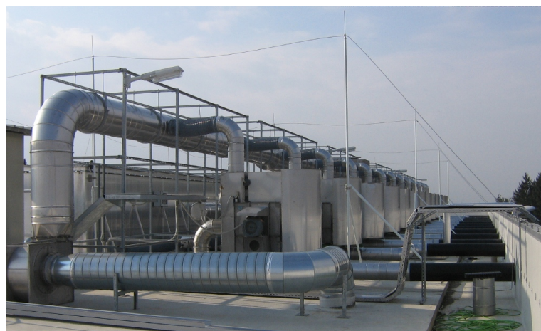
1. SISTEMA DI AERAZIONE FORZATA
